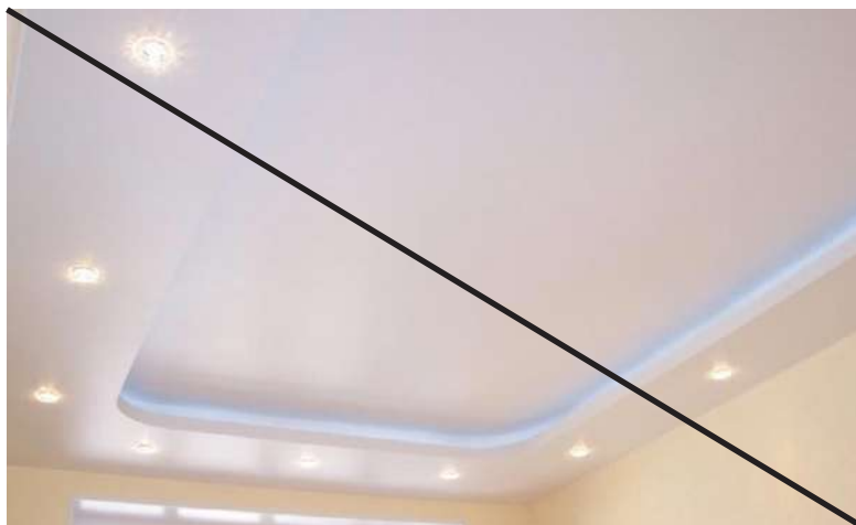
Плохо Многоуровневые гипсокартонные конструкции
